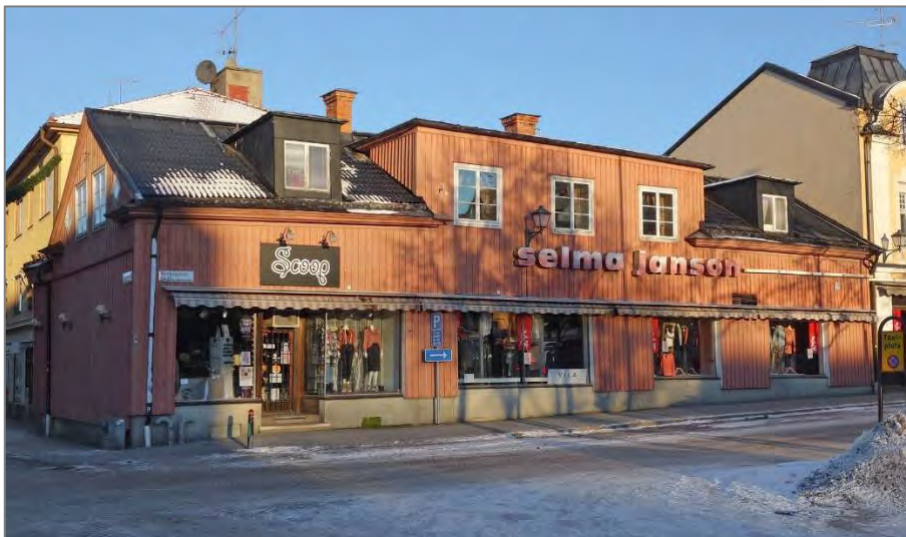
”Selma Janson” i hörnet Kyrkogatan/Källgatan, i kvarteret Buntmakaren, är ett talande exempel på de ovarsamma förändringar som gjorts på många av de äldre husen. Detta hus hade tidigare en putsad fasad och tegeltak (jämför med bilden på sidan 10).
